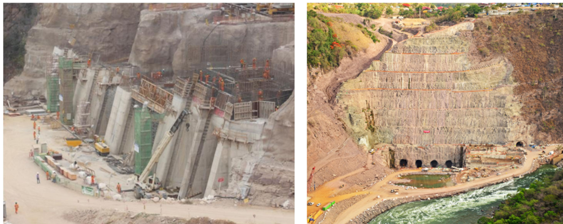
Figure 4. Construction d'une centrale hydroélectrique de quatre unités de production de 175 MW chacune (total 700 MW) et d'un circuit hydraulique, dans le cadre du rehaussement du barrage de Cambambe (augmentation de la hauteur du barrage existant de 30 mètres). Assistance technique à l'ENE dans le cadre de l'examen et de l'approbation du projet de construction civile.
