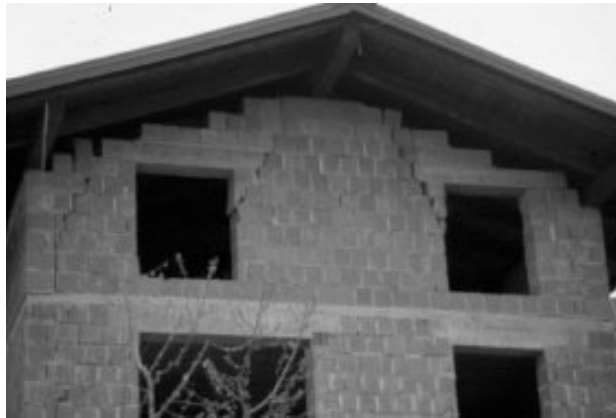
Figure 11: Rupture « in-plane » d'un mur en maçonnerie
