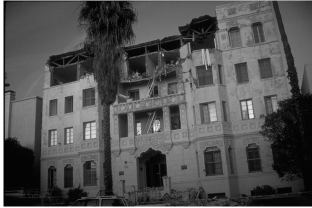
Figure 13: Rupture hors du plan (« out-of-plane ») de murs en maçonnerie
