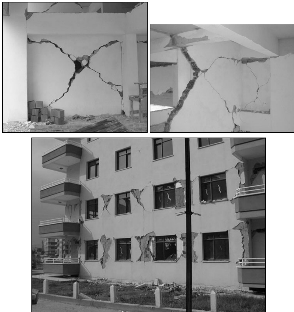
Figure 10: Rupture « in-plane » en X des murs de maçonnerie.
