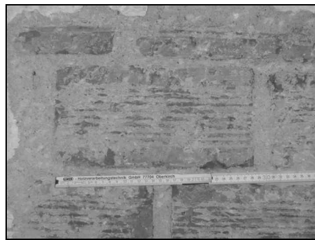
Figure 34: Exemple d'un bout de mur porteur en maçonnerie de briques (Bâtiment n°6, Aigle)
