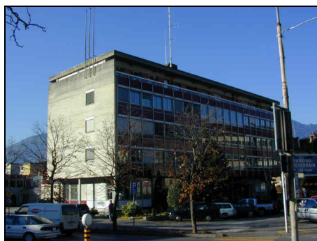
Figure 7: Exemple de bâtiment avec murs en béton armé (bâtiment de l'administration d'Aigle)
